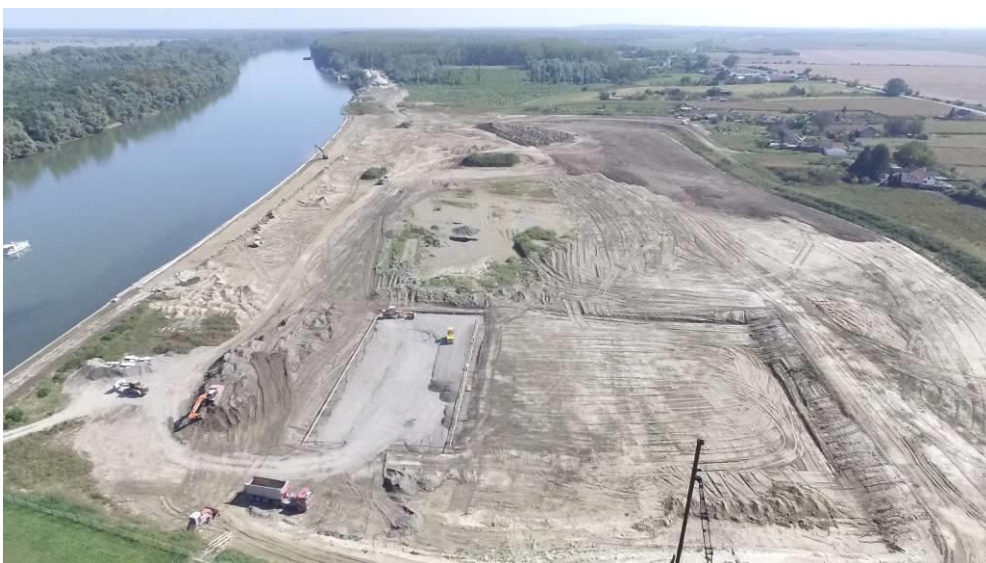
Slika 6: Zračna snimka Uređaja za pročišćavanje otpadnih voda grada Osijeka u fazi izgradnje
